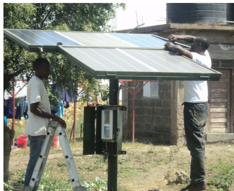
Solarpaneelen mit Steuerkasten
